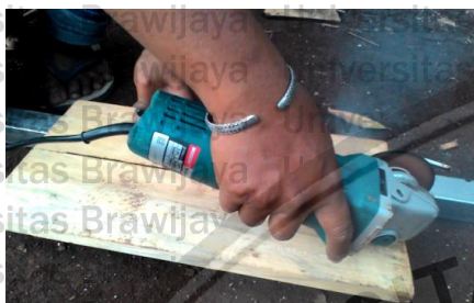
Gambar 4.36 Proses pemotongan yang berbahaya tanpa pelindung
