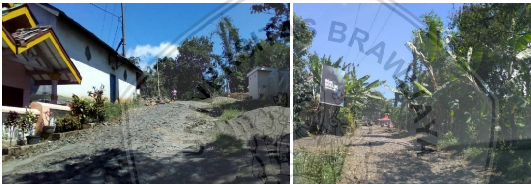
Gambar 4. 1 Kerusakan Jalan di Desa Sariwani
