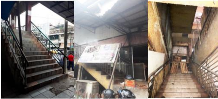
Gambar 4. 23 Kondisi eksisting tangga
