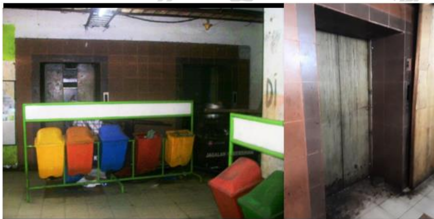
Gambar 4. 22 Kondisi eksisting lift penumpang
