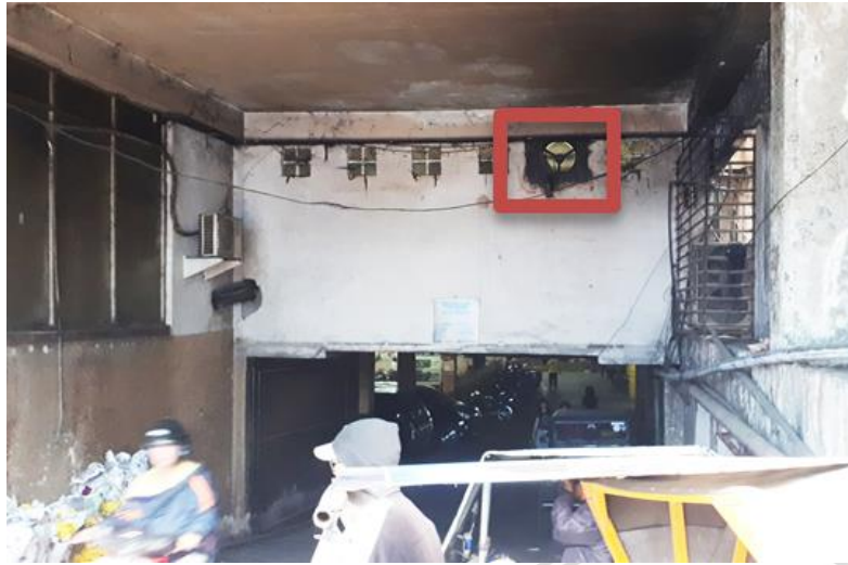
Gambar 4. 52 Kondisi eksisting fan Gedung
