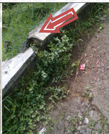
Retakan penahan jalan
