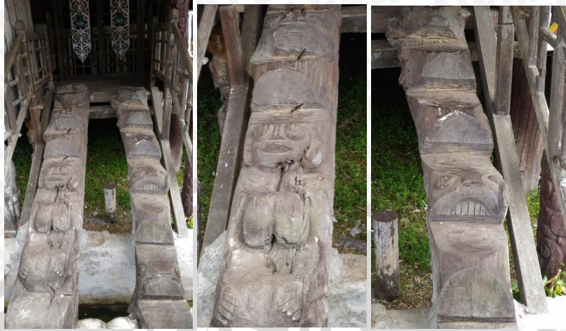
Gambar 4.64 Kondisi Tangga Masuk Tambahan
