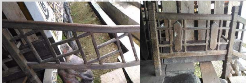
Gambar 4.65 Kondisi Railing pada Tangga Masuk
