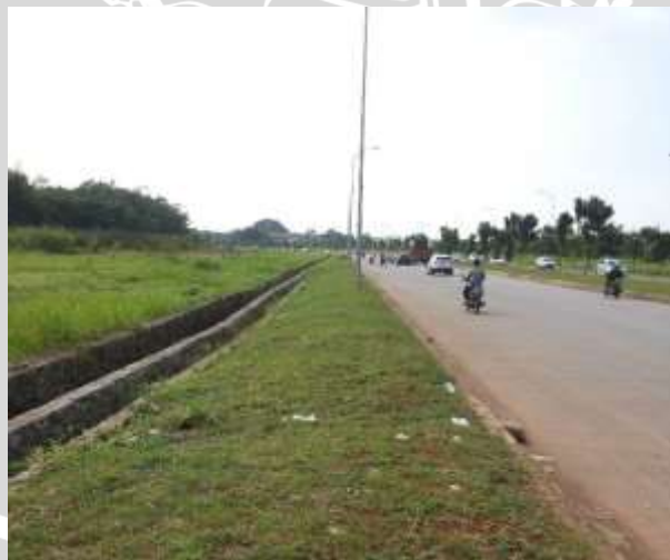
Gambar 4. 12 Kondisi bahu jalan Sumber: Dokumentasi Pribadi
