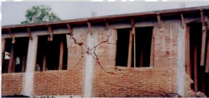
Gambar 2.7. Retak pada bukaan jendela
