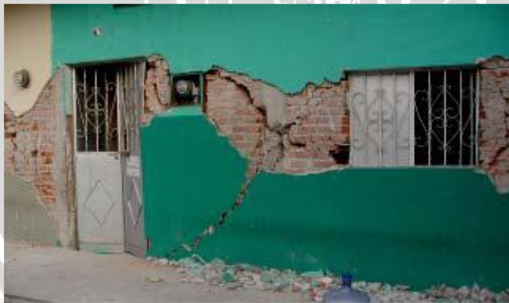
Gambar 2.8 Retak pada bukaan pintu
