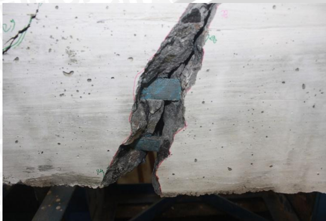
Gambar 4.32 Tulangan Mengalami Selip pada Beton
