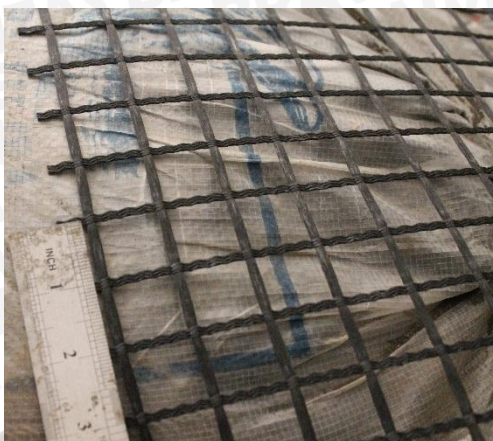
Kondisi awal geogrid
