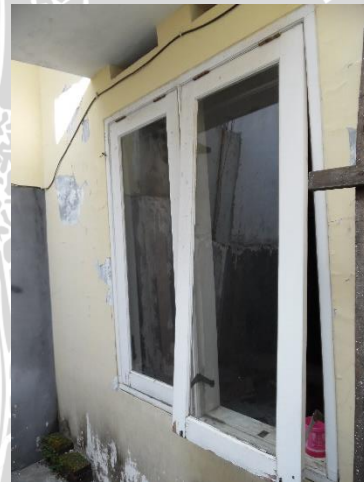
Gambar 4.18 Jendela pada Ruang III
