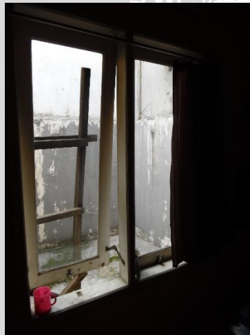
Gambar 4.17 Jendela pada Ruang III
