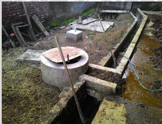
Gambar 4. 12 Salah Satu Digester Biogas Eksisting di Desa Gadingkulon
