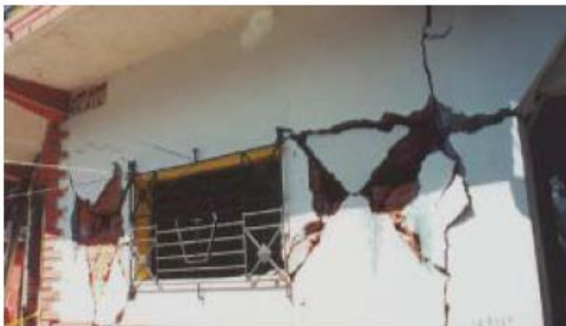
Gambar 2.4 Keruntuhan pada dinding dengan bukaan Sumber : (EERI, 2001, dalam Meli et al , 2011)
