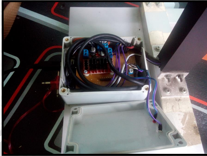
Rangkaian elektrik pada alat
