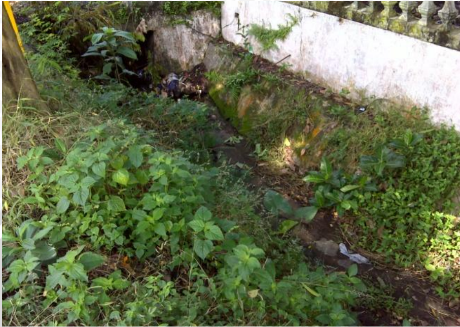
Gambar 1.2 Saluran Drainase dengan Kondisi Tertutup Sampah dan Ditumbuhi Rumput-rumputan
