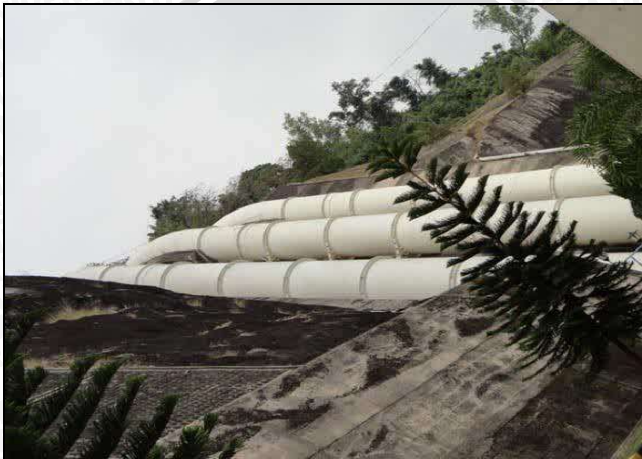
Gambar 3.3. Pipa Penstock PLTA Waduk Sutami
