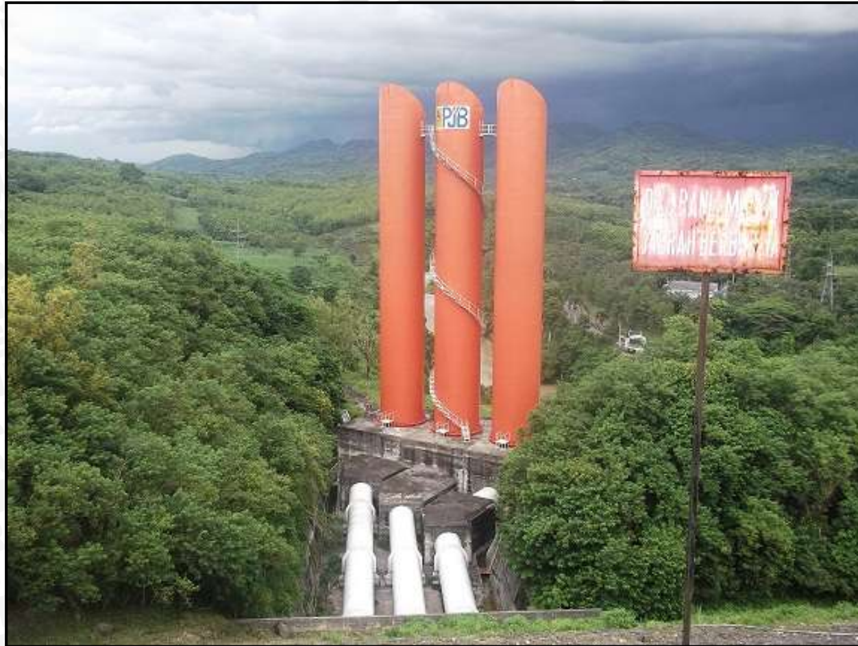
Gambar 3.5. Cerobong Udara PLTA Waduk Sutami
