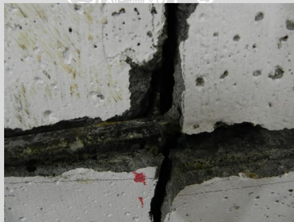
Gambar 4. 12 Tulangan Lepas Dari Beton
