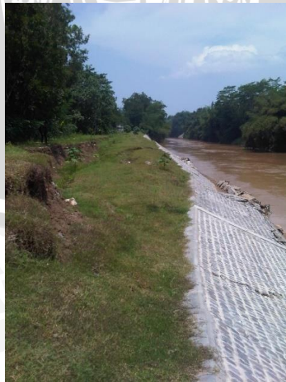
Gambar 3.3 Kondisi dinding penahan eksisting tinjauan di lapangan
