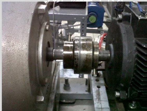
Foto Kopelan Motor Induksi dengan Beban (Generator) untuk Pengujian Berbeban
