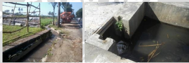
Gambar 4.26 Drainase di daerah Jalan Tlogowaru
