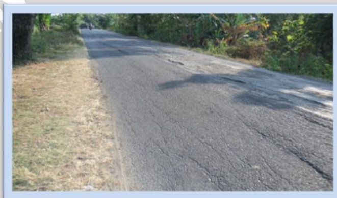
Kerusakan disepanjang jalan Kec. Paron Kab. Ngawi
