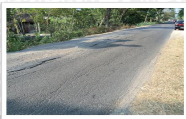
Kerusakan disepanjang jalan Kec. Paron Kab. Ngawi
