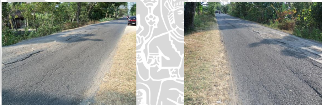
Gambar 4.1 Kondisi Eksisting Perkerasan Jalan Ruas Paron-Ngawi
