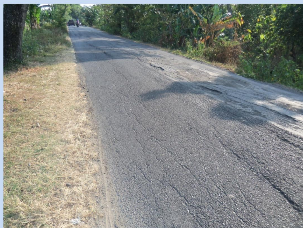
Kerusakan disepanjang jalan Kec. Paron Kab. Ngawi
