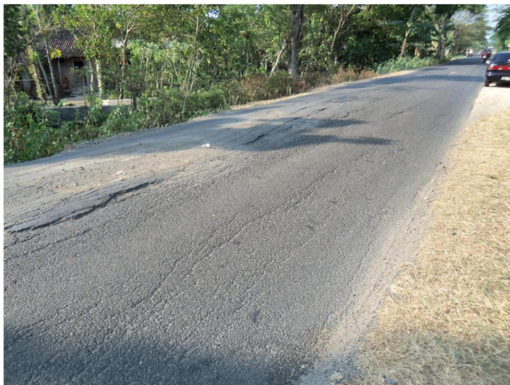
Kerusakan disepanjang jalan Kec. Paron Kab. Ngawi
