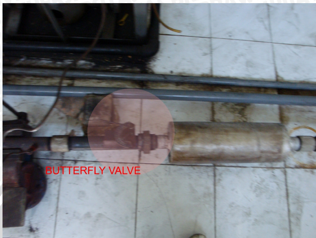
Gambar peletakan butterfly valve pada instalasi
