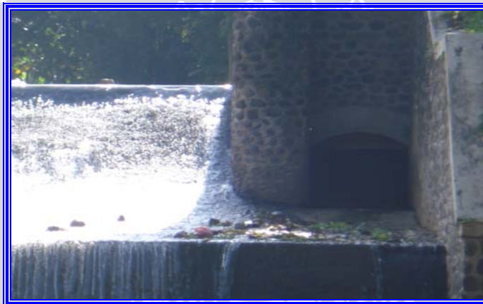
Gambar 3.9. Pintu Penguras Bendung Sonosari
