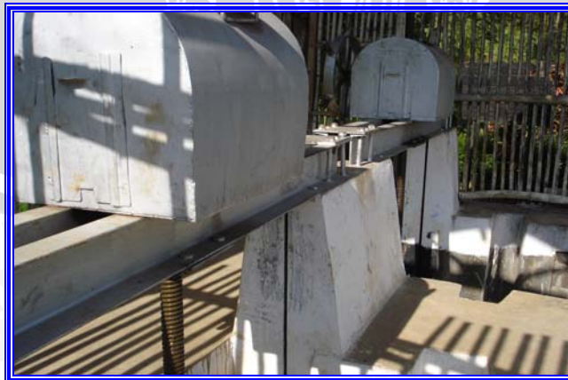
Gambar 3.7. Pintu Intake DI Metro Hilir
