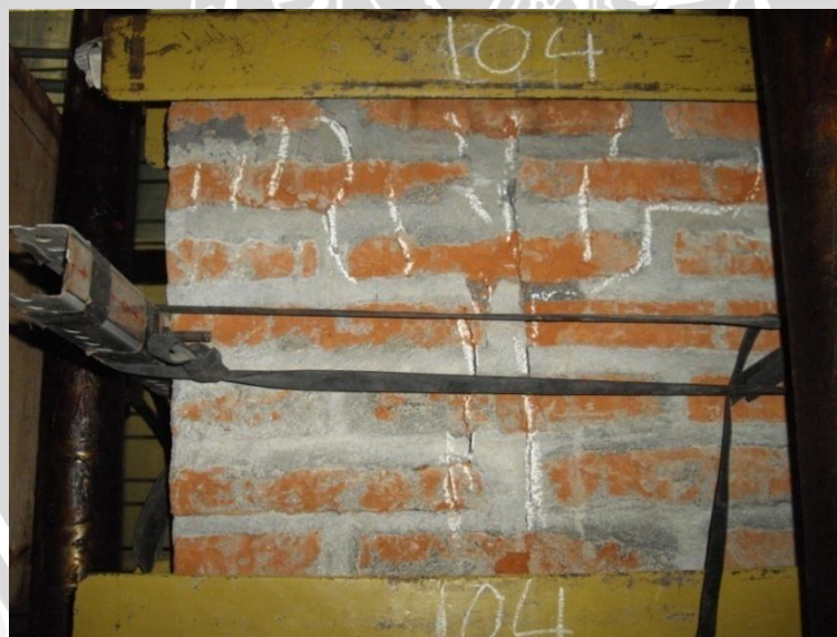
Gambar 14. Pola retakan yang terjadi pada dinding bata komposisi mortar 1:3, benda uji 3
