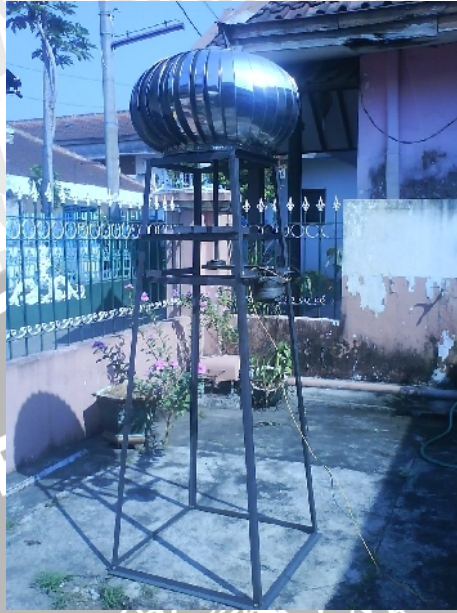
Gambar 6.1. Ventilator kubah dan tower
