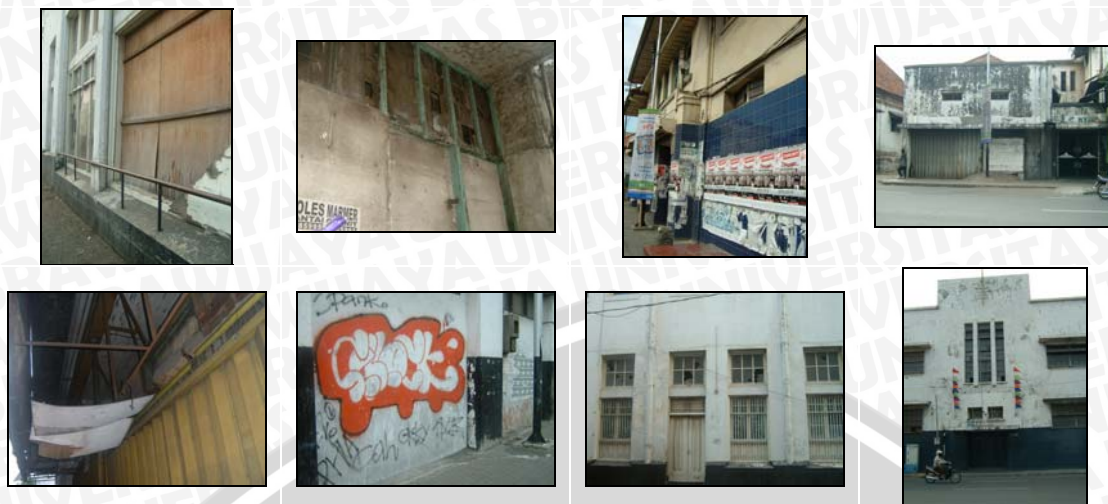
Gambar 4. 29 Kerusakan pada fasade bangunan di koridor Jalan Veteran
