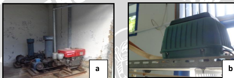
Gambar 11. Blower (a) Root Blower, dan (b) Hi Blow
