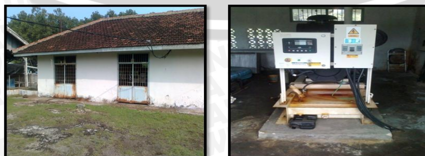
Gambar 8. Sistem Penyediaan Energi, (a) Rumah genset dan (b) Generator set
