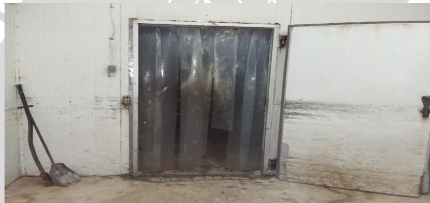
Gambar 5. Ruang penyimpanan beku
