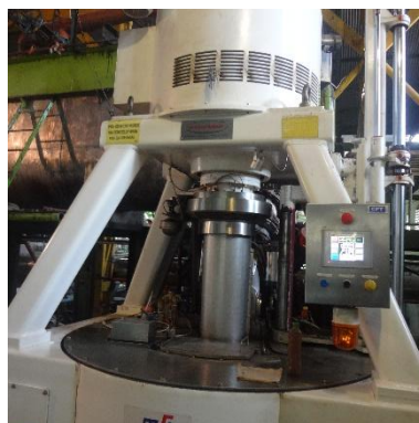
Gambar 16. Puteran High Grade Fugal (HGF) (Sumber : Dokumentasi peneliti, 2016)
