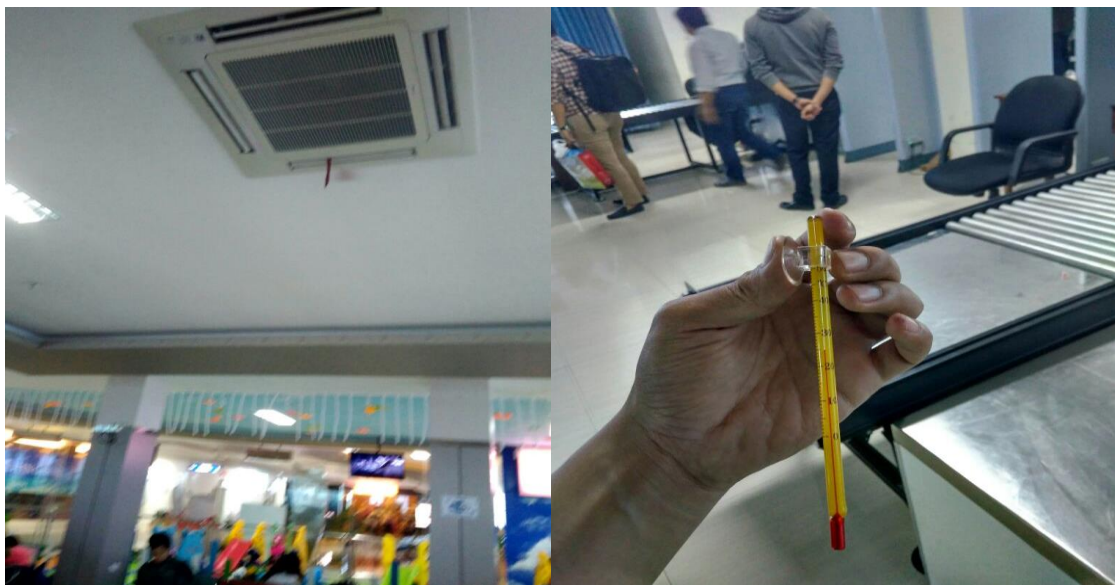
Gambar 4.12 Kondisi air conditioner (AC) serta suhu di ruang tunggu keberangkatan Sumber: Dokumentasi Bandar Udara Abdulrachman Saleh
