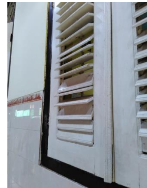
Krepyak pada jendela massa A mengalami kerusakan.
