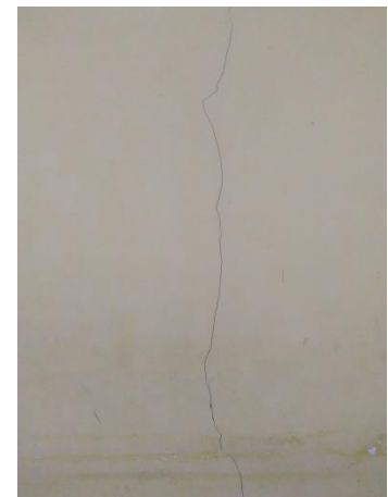
Dinding retak pada massa B
