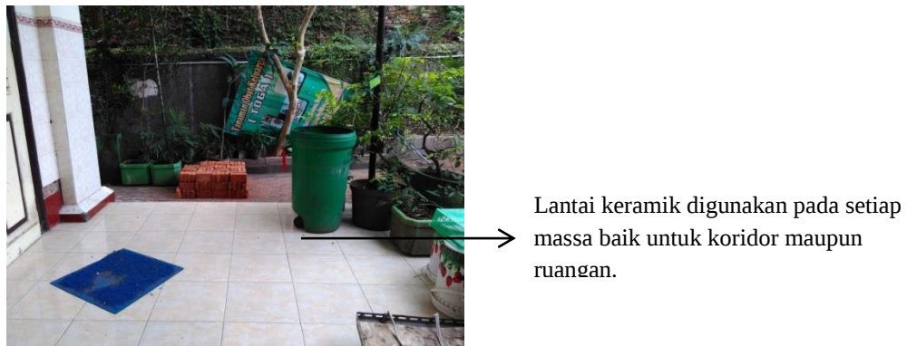
Gambar 4.111 Perubahan pada Lantai
