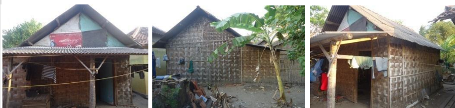
Gambar 4.5 Rumah Sebelum menerima bantuan Rehabilitasi RTLH
