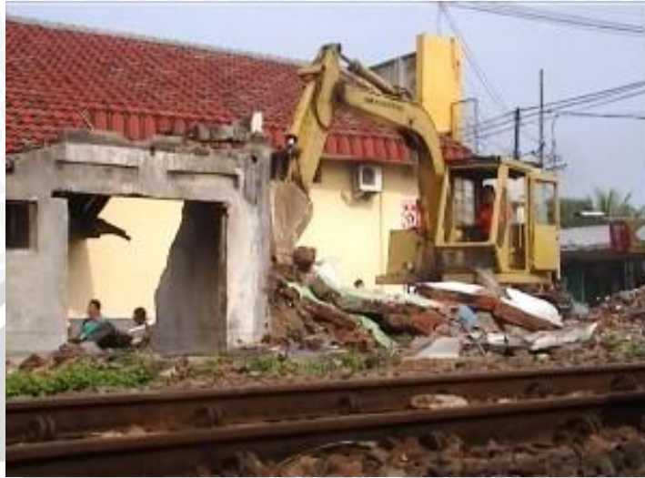
Gambar 3 : Bangunan yg dibongkar karna tidak sesuai IMB di daerah pasar setono betek
