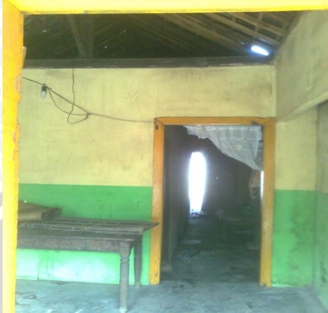
Kondisi rumah tangga penerima pemanfaat Kegiatan Sarpras Rehab Rumah (Foto tanggal 9 Februari 2013)
